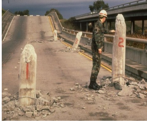
Fig.1.7 : Poinçonnement du tablier sous l'effet de la composante verticale du séisme séisme de Loma Prieta (USA 1989) 5
