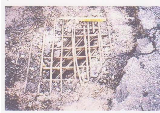
Fig. 3.23: Etanchéité et dalle en état très détérioré [1].
