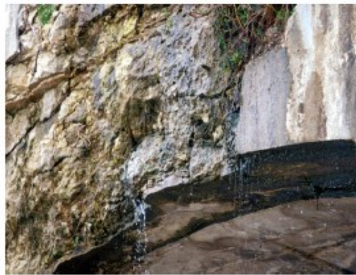
Fig. 3.10 : Présence d'eau interne circulant dans la maçonnerie 27
