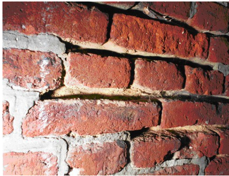
Fig. 3.6 : Disjointoiement profond sur une maçonnerie de briques [6].
