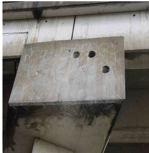
Fig. 4.8 : Prélèvements sur un chevêtre présentant un réseau de fissures 49
