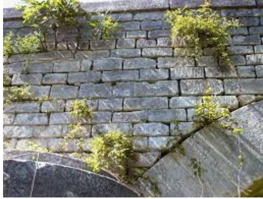
Fig. 3.11: Végétations sur les murs tympans (preuve de présence d'eau interne) 28
