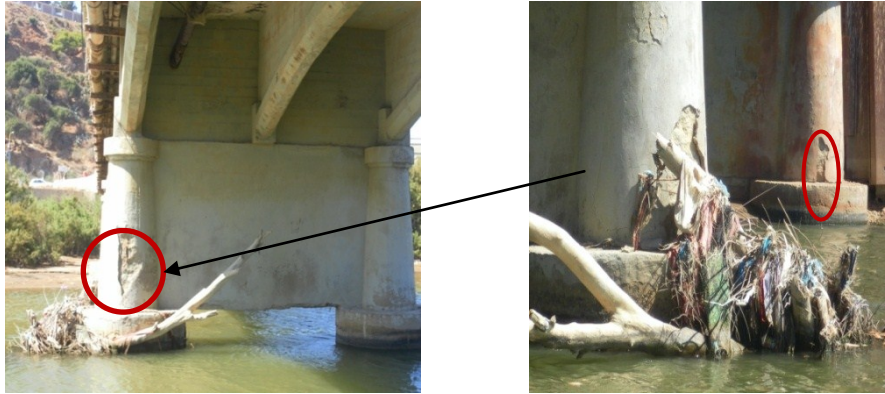
Fig 1.5 : Désordre à la base des piles du pont sur Oued Allala (Ténès-Algérie) sous l'effet de l'abrasion 4
