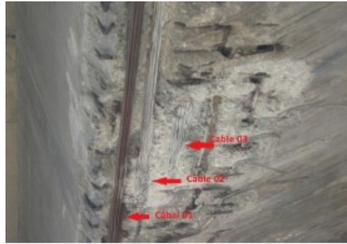
Fig. 5.9 : Précontrainte endommagés sous l'effet des chocs de véhicules (pont sur l'échangeur de la rampe des Fusillés-Alger) 65
