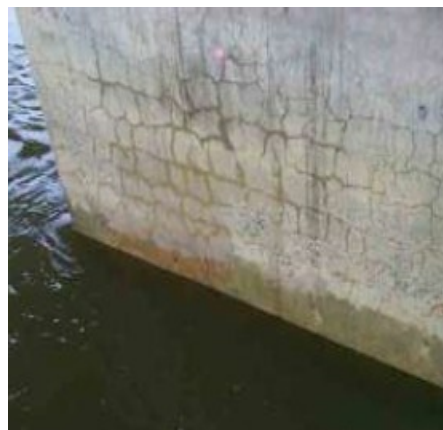
Fig. 2.3: Pathologie due à l'attaque des sulfates sur la pile d'un pont 17
