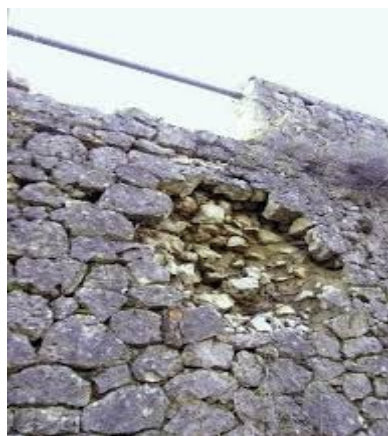
Fig.3.7 : Déstabilisation et chute de pierres de maçonnerie 25
