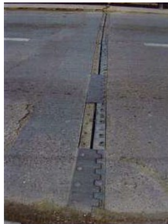
Fig. 3.22: Joint de chaussée fortement endommagé : arrachement de plusieurs éléments du joint sous l'effet du trafic routier 41
