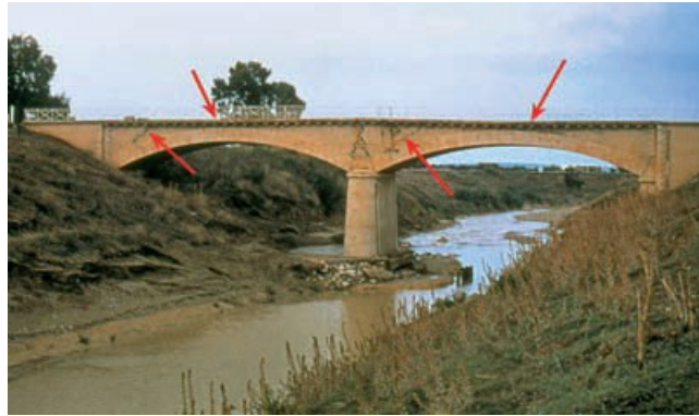
Fig. 3.24: Tassement de la pile médiane d'un pont due à l'affouillement local de sa fondation [10]
