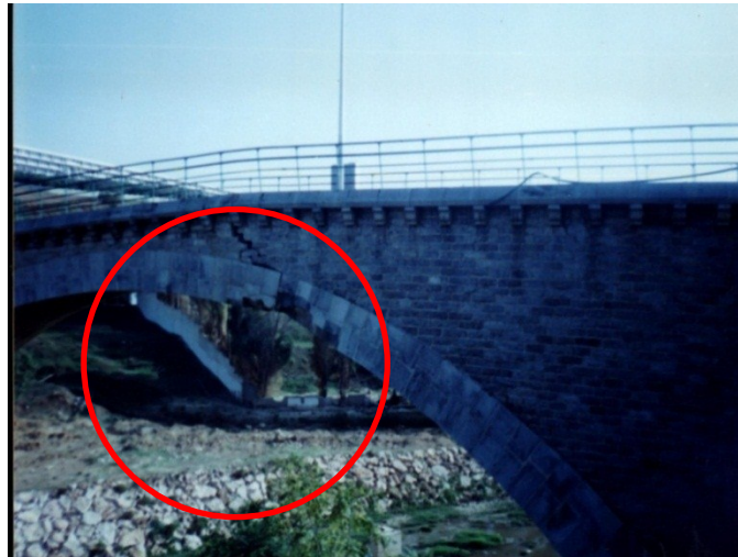
Fig.3.8 : Pont en maçonnerie gravement fracturé au niveau du tympan (ville de Constantine) 26
