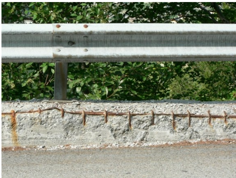
Fig. 2.7 : Effet du gel-dégel sur le béton : écaillage du béton d'enrobage et corrosion des armatures 19
