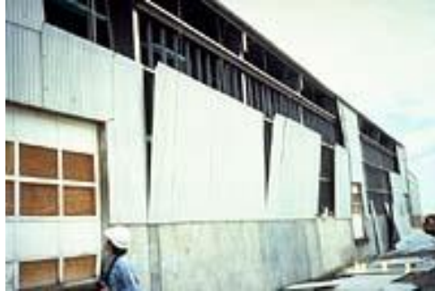
Figure 2.27: Séisme Coalinga, 1983. Détachement du bardage de façade.
