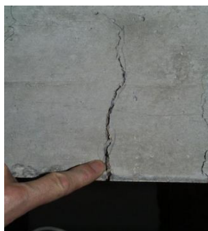
Figure 1.8 : Apparition des fissures causée par le décoffrage prématuré.
