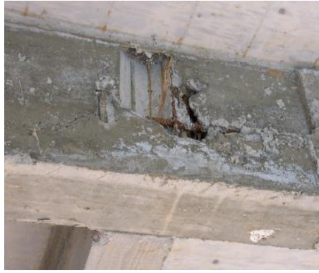
Figure 2.57 : Béton non vibré : manque de matière et enrobage des aciers non réalisé [18].
