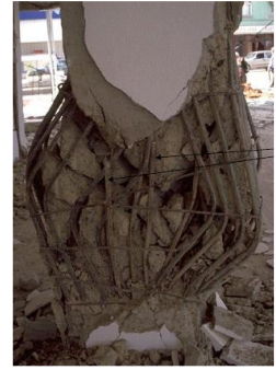
(c) Séisme Izmit 1999
