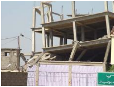
(a) Séisme Boumerdes 2003
