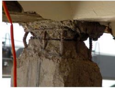
(b) Séisme Boumerdes 2003
