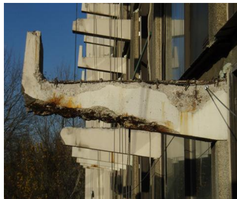
Figure 1.10 : Dégradation du béton causée par la carbonatation.
