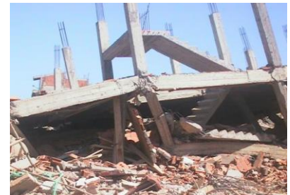
(c) Séisme Boumerdes 2003
