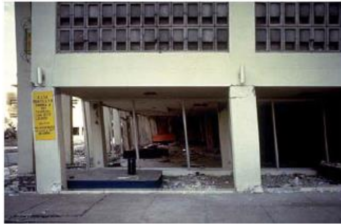
Figure 2.39 : Cisaillement des poteaux du RDC causé par le phénomène de « Poteau faible –Poutre forte » [20].
