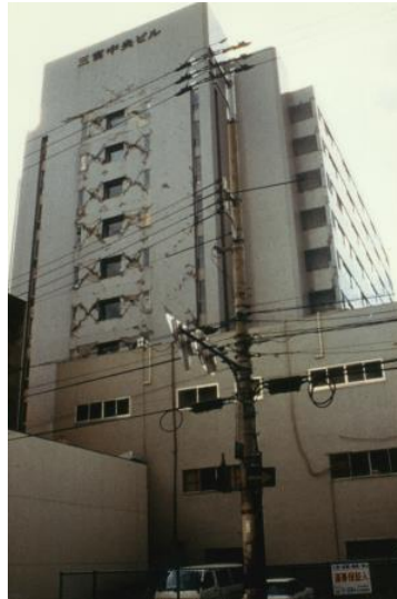
Figure 2.51 : Rupture des voiles du bâtiment (Great Hanshin) (séisme Kobé Japon 1995).
