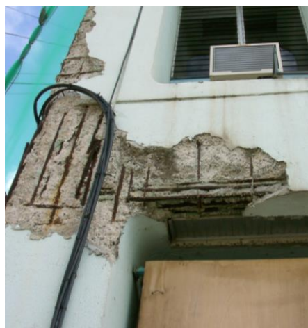
Figure 1.16 : Dégradation des éléments structuraux causé par la corrosion des armatures [18].
