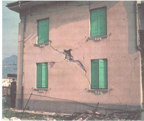
Figure 2.2: Fissuration de la maçonnerie (Séisme Frioul, Italie 1976) [20].
