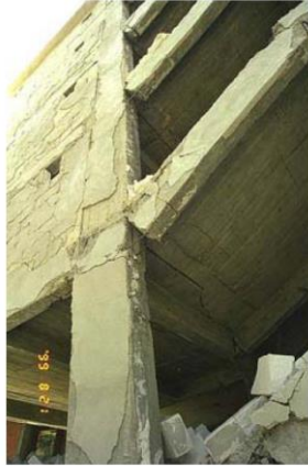
Figure 2.55 : Dommages des poutres non ductiles [24].
