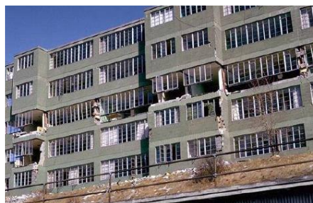
(b) Séisme d'Anchorage, Alaska 1964
