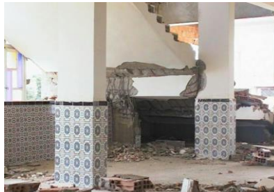
(b) Séisme Boumerdes 2003
