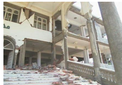
(b) Séisme de Boumerdes 2003
