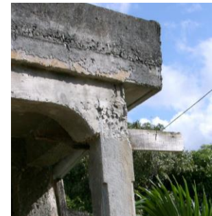
(c) Séisme Boumerdes 2003
