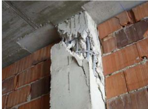
Figure 1.6: endommagement du poteau causé par le déplacement du coffrage.
